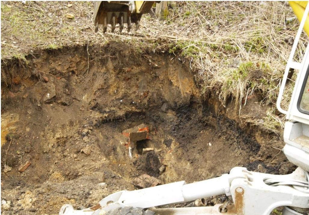
Obr. 4 Zbytky větracího komínu nad zřícenou štolou B
